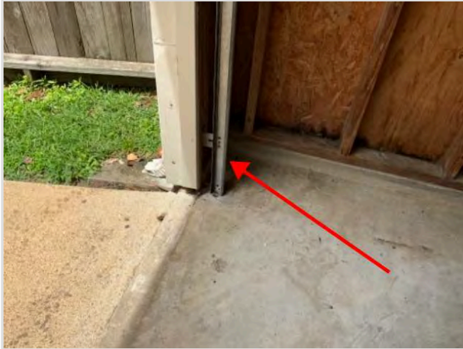
No garage door sensors
